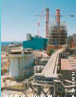
Centrale de Torrevaldaliga
