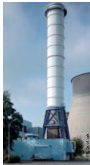
Turbine à gaz de Mol
